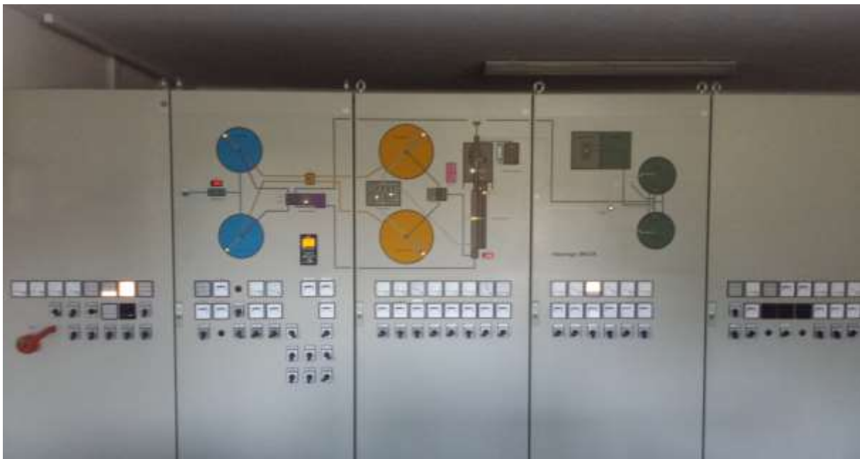
Abb. 3: Schaltwarte der Kläranlage Brück (AZV Planeta)
