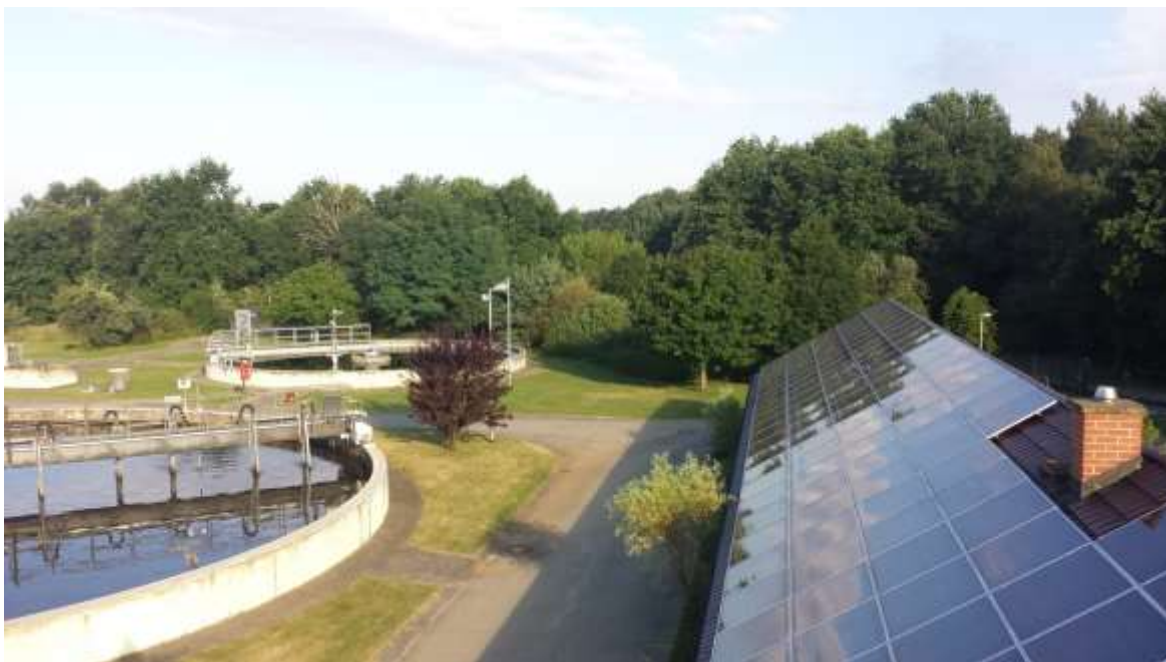
Abb. 6: Kläranlage Brück mit Belebungs- und Nachklärbecken sowie dem Betriebsgebäude mit Solaranlage (AZV Planetal)
