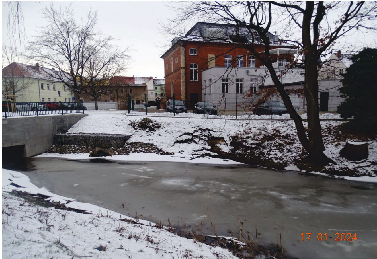
Mühlgraben Bad Liebenwerda, Erosionsschaden – linke Wasserlaufböschung unterhalb Durchlass Stirnwand in der Ortslage Bad Liebenwerda
