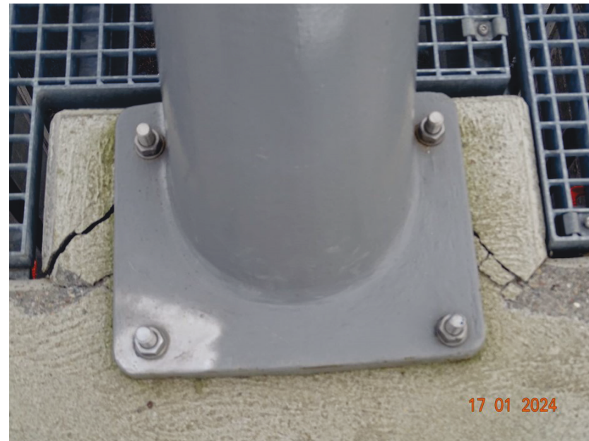
Betonschäden Siel Brottewitz (Elbe)
