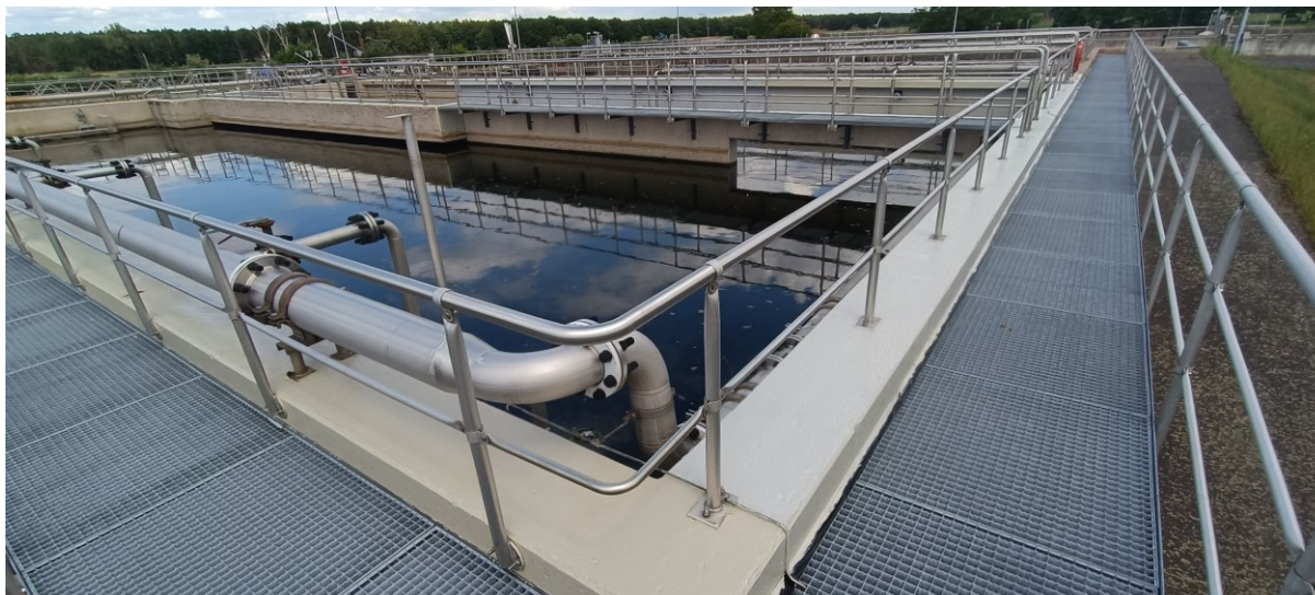
Abbildung 12: Belebungsbecken auf der Kläranlage Kremmen (ZV Kremmen)
