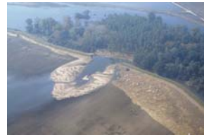
Deichbruch bei Polbitz, Elbe-HW 2002 (Foto: Ott)
